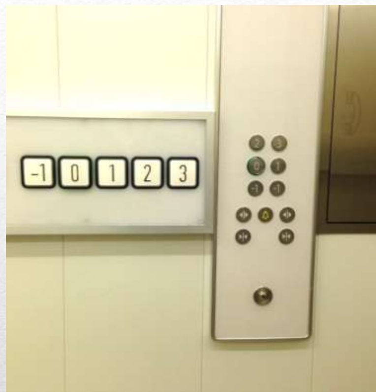
Larges touches dans les ascenseurs et à hauteur de vue
